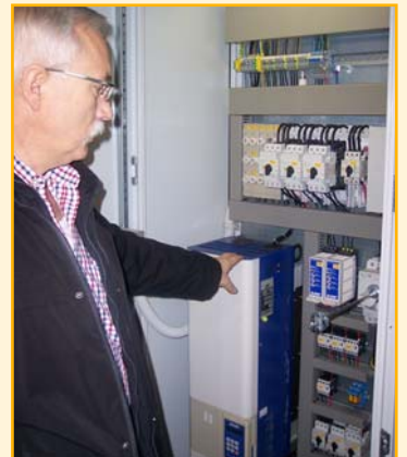
Frequenzumrichter im Schaltschrank zur Drehzahl-Regelung der Lüfter.
