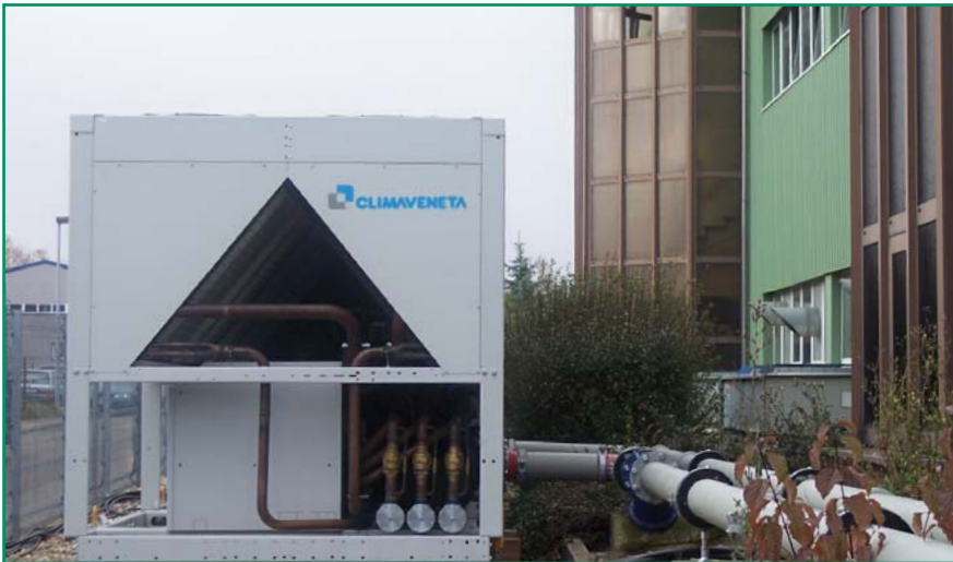
Die extern installierte Kühlanlage des italienischen Herstellers CLIMAVENETA sorgt im Langenbrander Werk für eine konstante Kühlwassertemperatur in der Produktion.
