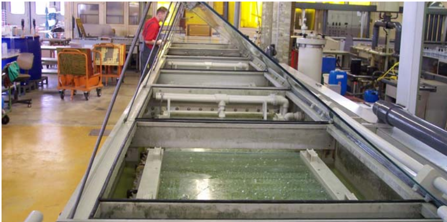
Die chem. Zinn Anlage ist durch den Einbau von 4 zusätzlichen Modulen auf über 14 m angewachsen.
