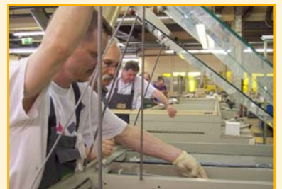
Die neuen Zinn-Elektrolyt-Module sind 6,60 Meter lang.
