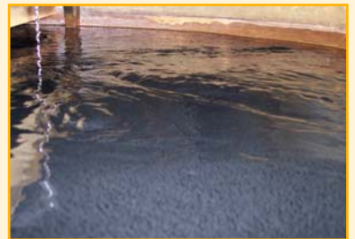
„Flockungsstufe“: Hier werden Rückstände sämtlicher Spülwässer gebunden, bzw. zum Ausflocken gebracht.
