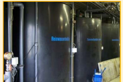
Hausinterne Aufbereitungsanlage: Reinwasser- und Abwasserbehälter.
