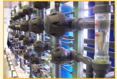
Modernste Technik: Verteil- und Filterstation für Frischwasser
